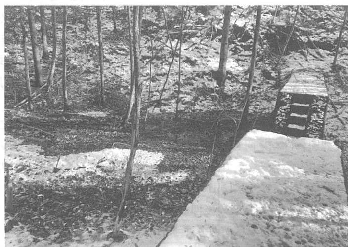
溪流に設置された砂防ダム(冬季)。夏季にイネを栽培し測定した
